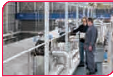
Door alle stoom van de autoclaven op te vangen en te hergebruiken wordt er aanzienlijk minder gas verbruikt in de fabriek
