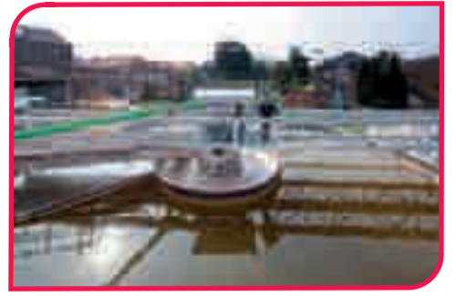
Een grote waterzuiveringsinstallatie zorgt ervoor dat al het geloosde water perfect voldoet aan de strengste normen
